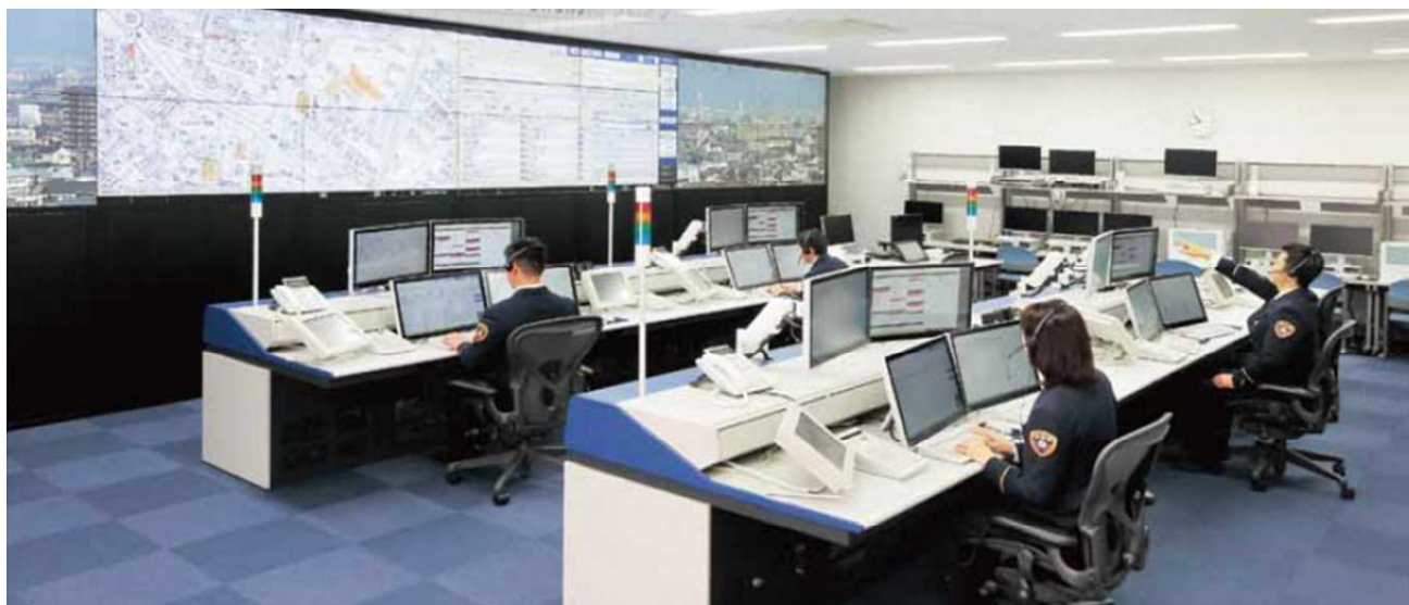
[消防指令システムⅡ型 指令台3台 指揮台1台]
