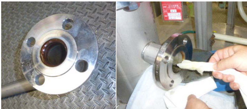
配管内部に油分が付着
