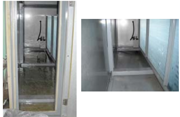
ファンコイル内部 (左: 漏洩時、右: 回収後)
