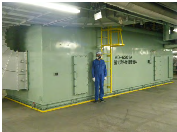
第 1 活性炭吸着槽 A
