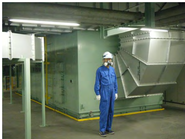
第 1 活性炭吸着槽 B
