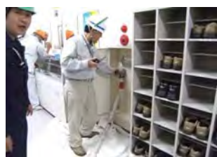
屋内消火栓元弁開放
