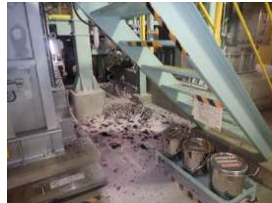
[焼損した蛇腹ホース落下後の作業場]
