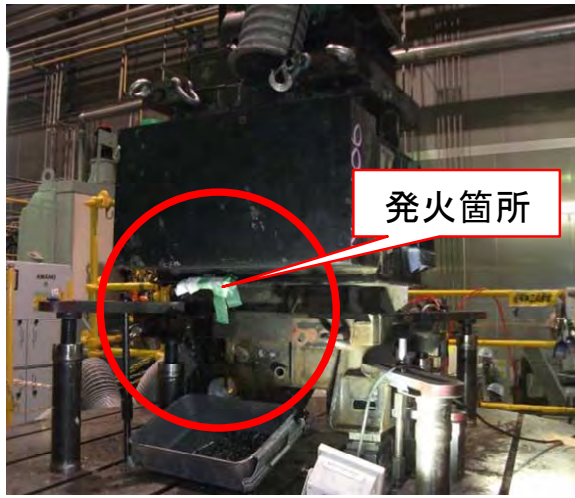
出火した車載トランス
