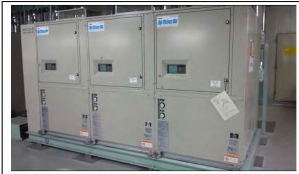
冷水ユニットB全体(左から1・2・3号機)
