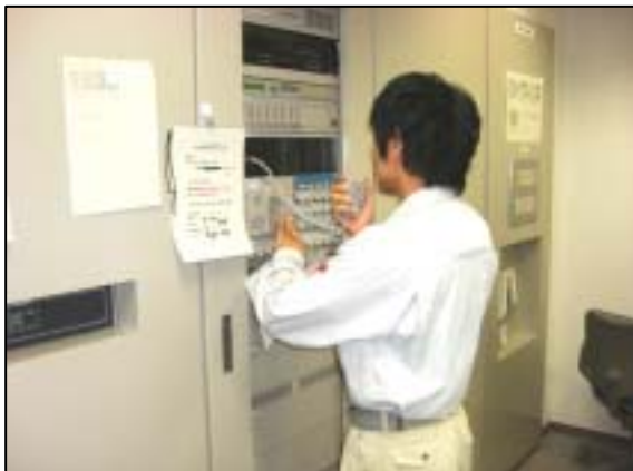
中央制御室から地震発生時の全館放送
