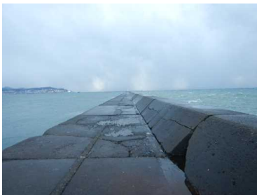
老朽化した 崎守地区北外防波堤
