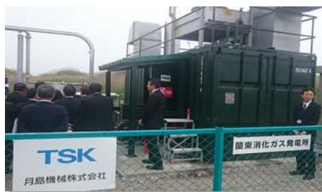
蘭東消化ガス発電所
