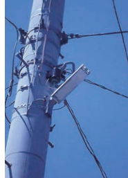
街路灯を設置・管理しています。
