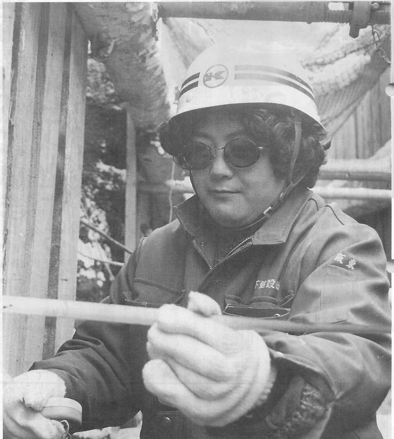
正確な施工と現場を安全管理— ぼん どう ゆかり 阪東 由香利さん(土木施工管理技士)
