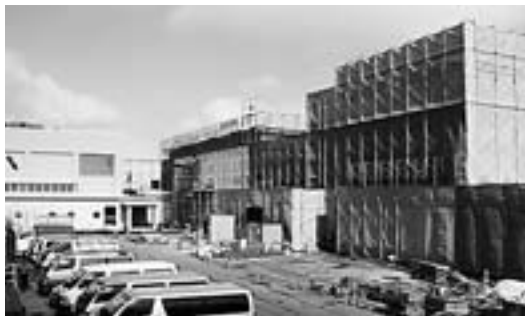
中島・日新小学校を統合した旭ヶ丘小学校を中島小学校グラウンドに建設中
