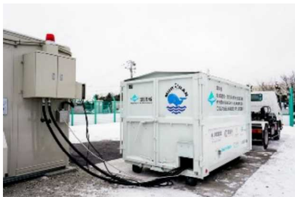
水素活用の実証事業 (風力発電を用いて製造した水素の車載タンクへの充填)
