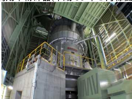
高効率粉砕器(平成 30 年 1 月稼働)
