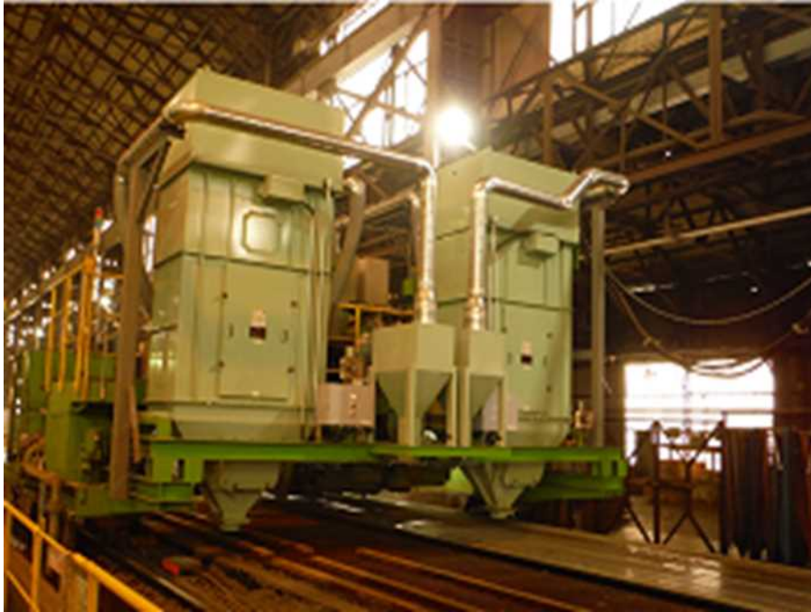
写真 局所集塵機を 2 台設置した研磨設備
