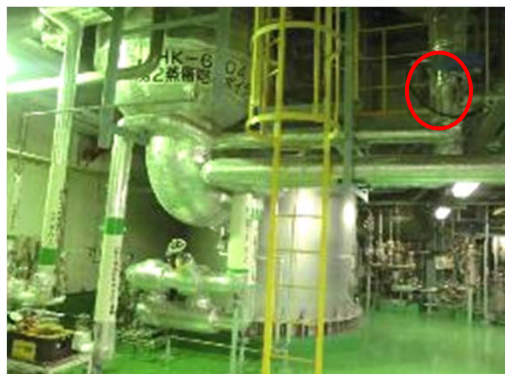
第2溶剤回収塔(H24. 9設置)
