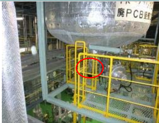
1階上部廃PCBタンク
