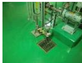
〔漏洩検知器〕 オイルパンなどに、PCB油の漏洩を検出するための検知器を設置
