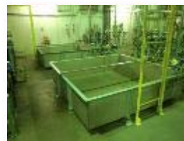
〔オイルパン〕 万が一油漏れが発生した場合、オイルパンが床面へのPCB漏洩を防止
