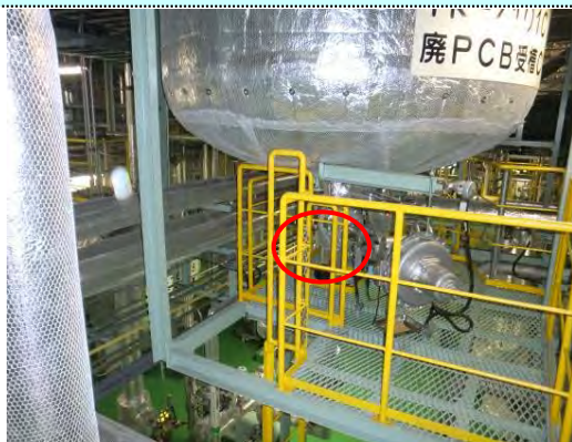
1階上部廃PCBタンク
