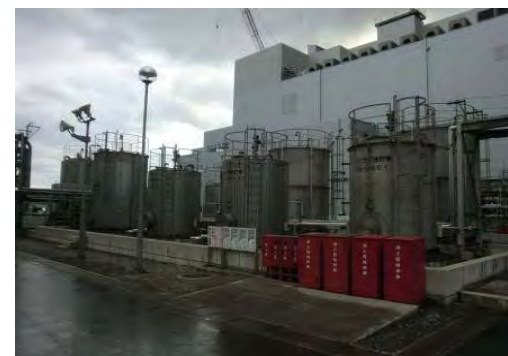
屋外貯槽類について設置した遮断弁等(例)
