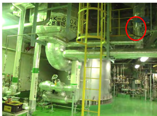
第2溶剤回収塔(H24. 9設置)
