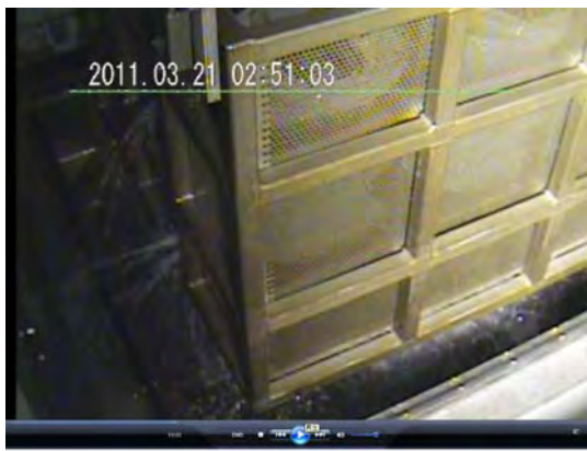
漏洩時の状況
