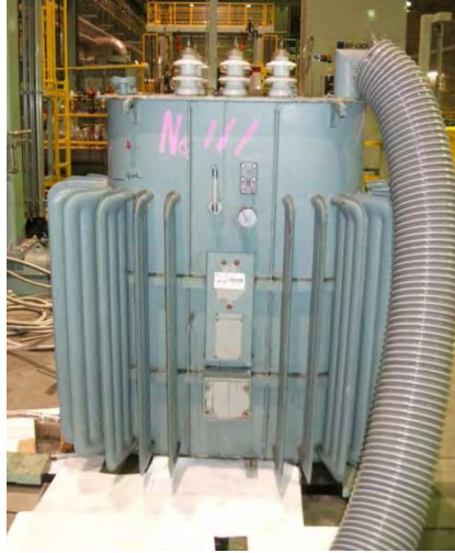
漏洩した大型トランス
