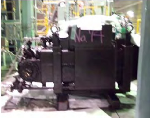
漏洩した車載トランス
