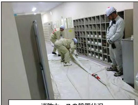
消防ホースの設置状況
