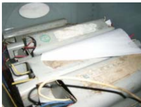
写真 水銀灯用安定器
