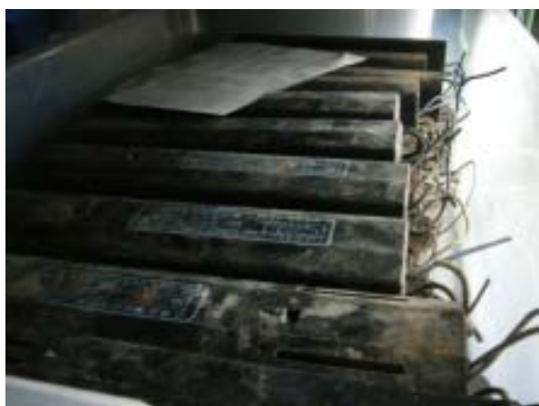
写真 蛍光灯用安定器
