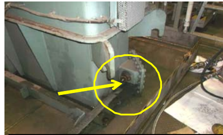
今回の漏洩箇所 高圧接地側端子接続部
