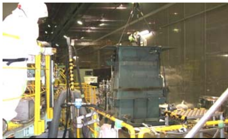
大型Tr #351 イグナイトン整流器用変圧器 本体全景
