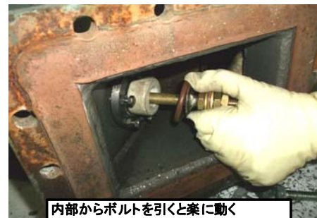
内部からボルトを引くと楽に動く状態となっていた。
