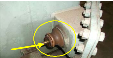
外部からの高電圧をトランスに引込むための接続部。本来は矢印部に締め付けナットが取り付けられ、内側からのボルトをナットで締めつける構造となっている。さらに保護カバーが取り付けられる。
