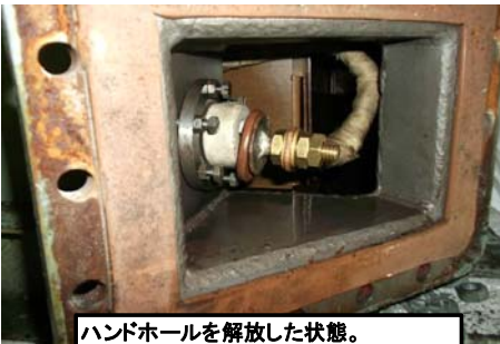
ハンドホールを解放した状態。
