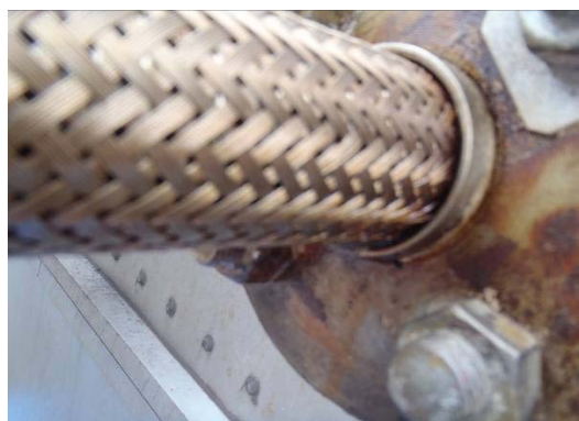
フレキシブルホース（漏洩箇所）
