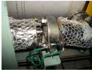
真空ポンプ冷却用給液配管 外観
