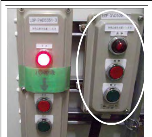
洗浄操作盤（白丸、上から運転中ランプ、開始ボタン（赤色）、停止ボタン（緑色））
