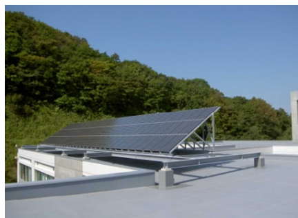
市内中学校の太陽光パネル
