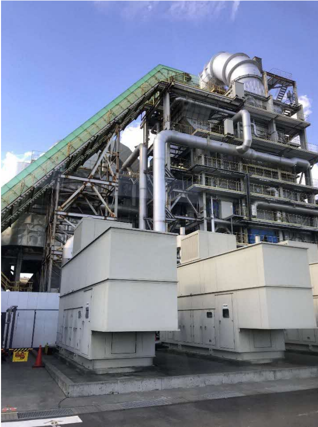
屋外設置焼却炉 仮設のため
